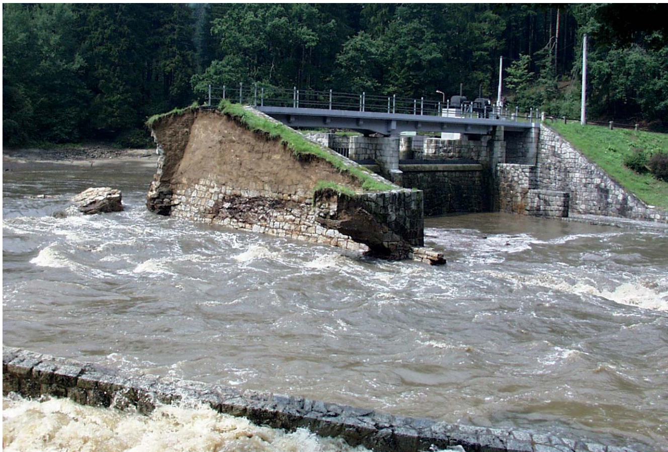
Destrukce hráze údolní nádrže Soběnov v roce 2002
